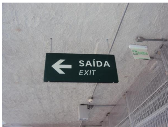
Figura nº 14: Placa de sinalização de emergência
