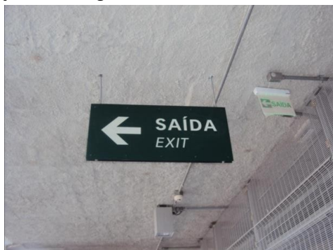
Figura nº 13: Placa de sinalização de emergência
