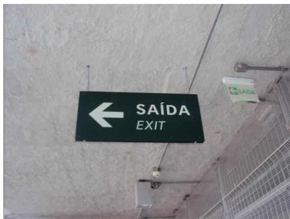
Figura nº 14: Placa de sinalização de emergência
